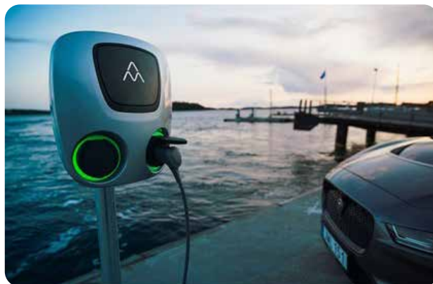
Laddstolpar för elbilar i Rönning.
